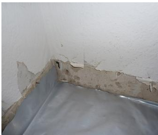
Abb.1: Mangelnde Ausführung der Wandabschlüsse
