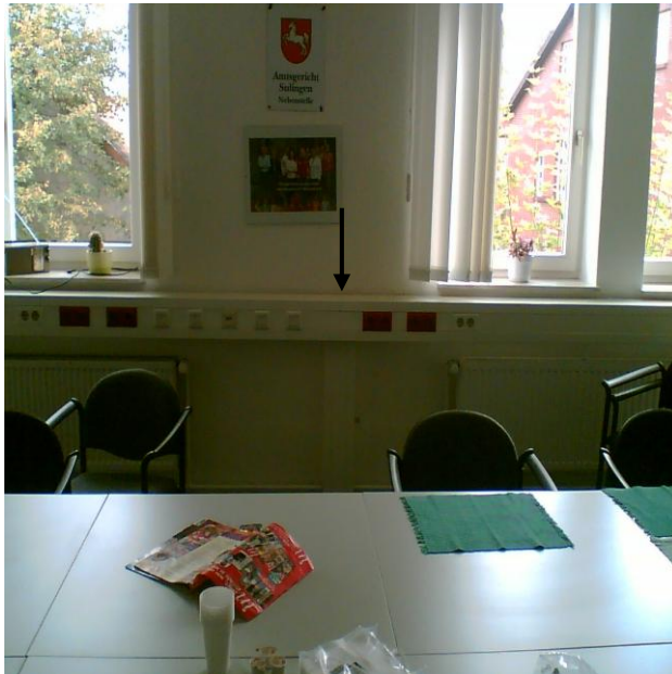
Abb. 9: Kabelkanaschacht, an dessen Austrittsstelle starker Geruch beobachtet wurde
