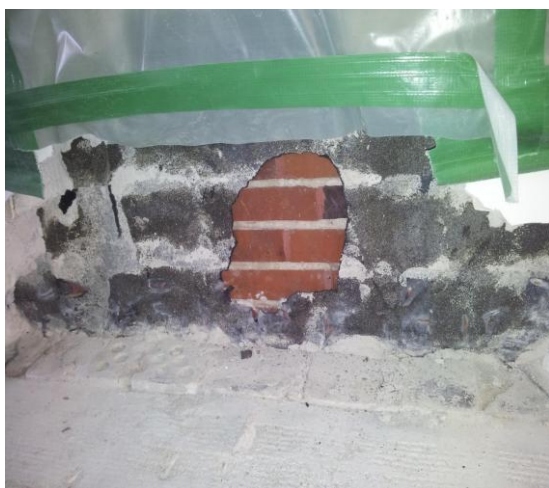
Abb. 13: Vertikal eingebaute Teerpappe zwischen Pausenhalle und Nachbarraum ursprünglich hinter Vorsatzschale (4.400 mg/kg Naphthalin, 4.400 mg/kg BaP, 95.000 mg/kg Summe PAK)
