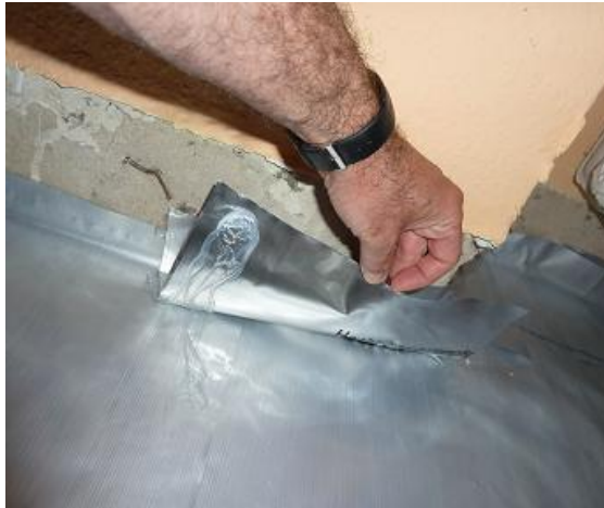
Abb. 3: Mangelnde Ausführung bei der Ausbildung von überlappenden Folienabschnitten, Verwendung von Klebmassen statt selbstklebender Alubänder und mangelnde Aushärtung der Klebmasse
